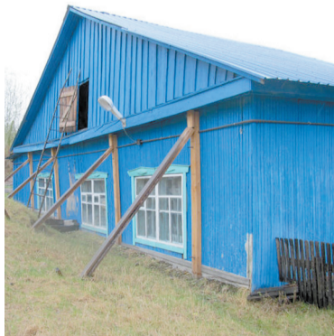
Аварийное здание школы в п. Экимчан Селемджинского района
